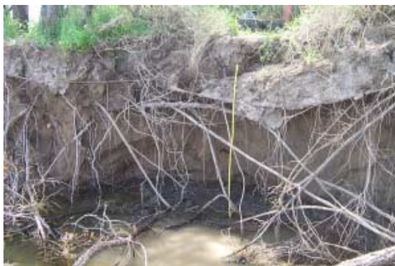
Figura 6.19. Vista del desmoronamiento de barrancas en el sitio Laguna del Fondo, Parque Luro
