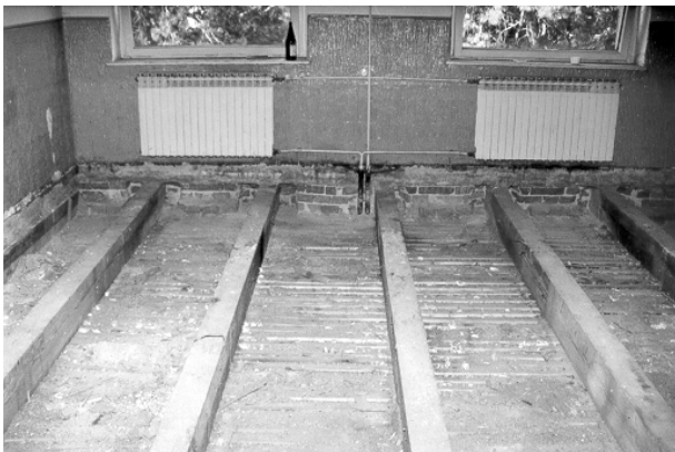
Slika 7. Izgled međuspratne drvene konstrukcije u jednoj od učionica pre sanacije
