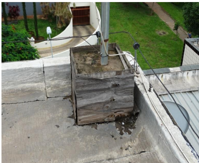
Figura 33 – Caixaote de madeira na base da antena parabólica.
