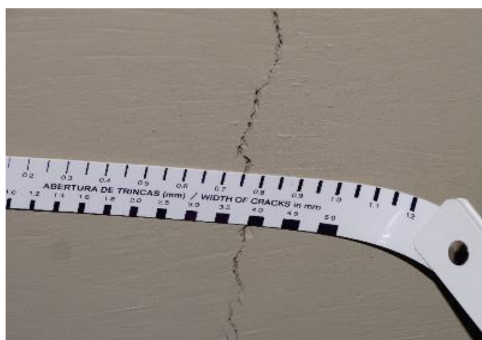
Figura 39 – Trincas/Fissuras nas paredes do Subsolo.
