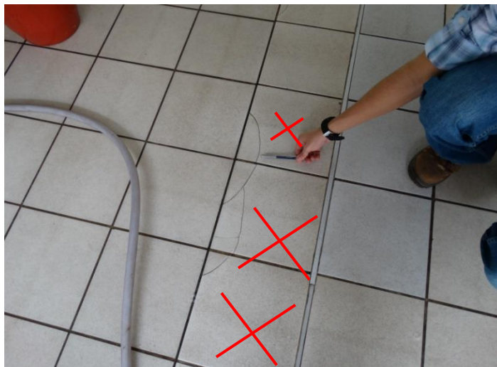
Figura 46 - Pontos em que a cerâmica do pilotis apresenta som cavo e oco.
