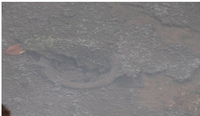
Figura 30 – Entupimento dos Ralos.
