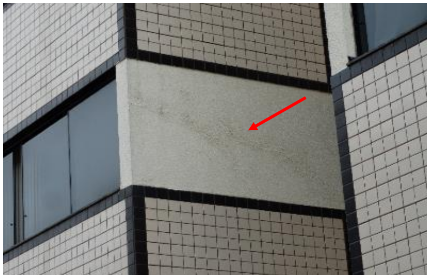
Figura 19 - Trincas/Fissuras na alvenaria das Varandas
