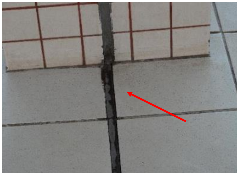
Figura 28 – Junta estrutural danificada.
