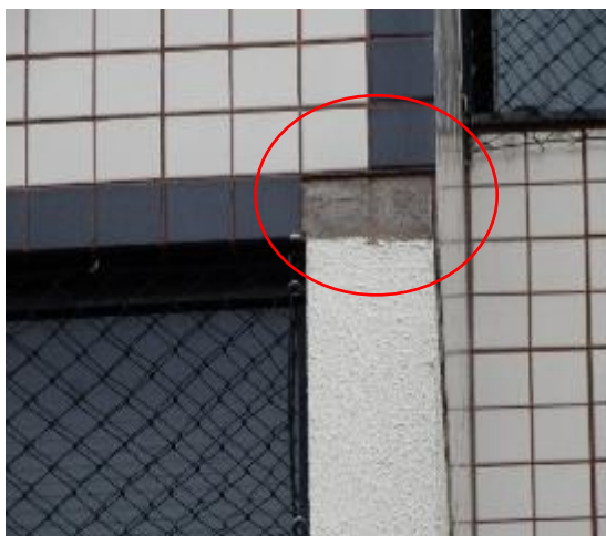
Figura 22 – Deslocamento do revestimento cerâmico na Fachada Leste
