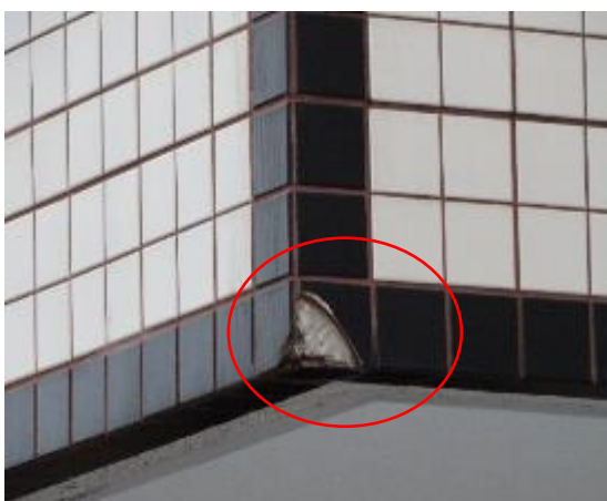
Figura 23 – Deslocamento do revestimento cerâmico na Fachada Leste
