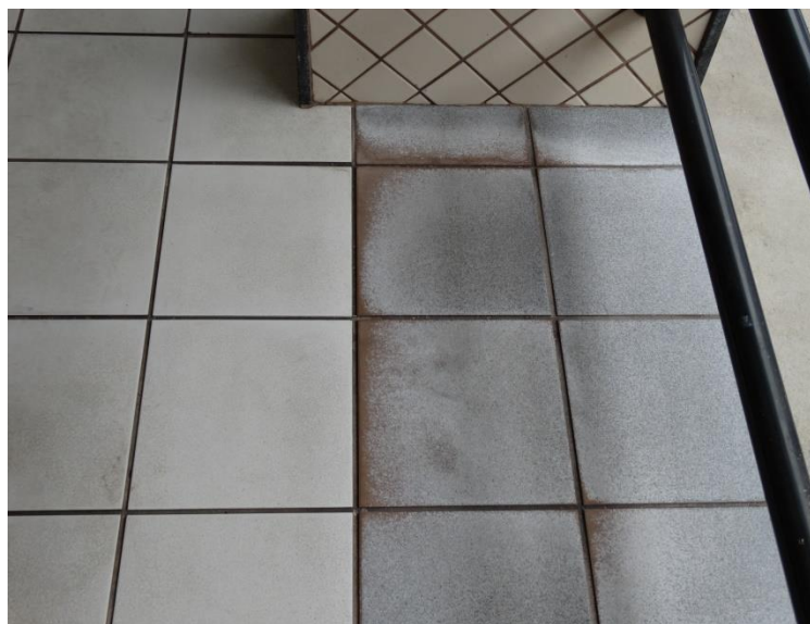
Figura 27 – Piso cerâmico desgastado.
