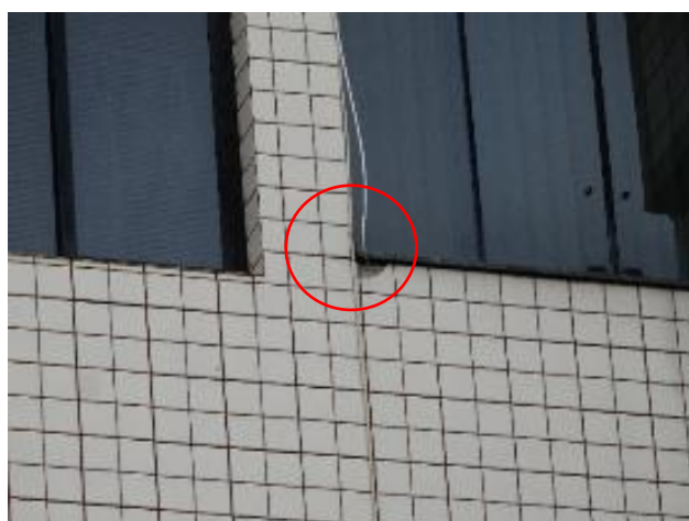
Figura 17 – Ponto de passagem de infiltração devido às instalações de equipamentos.
