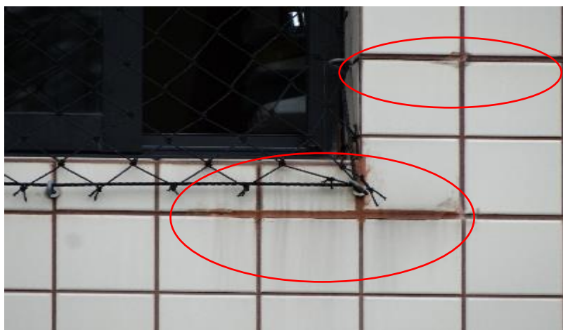
Figura 15 - Pontos com falhas no rejunte.
