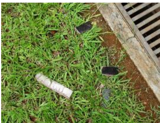
Figura 25 - Revestimento cerâmico deslocado encontrado no jardim
