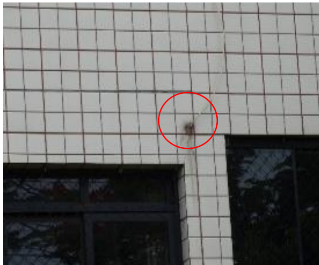
Figura 18 – Ponto de passagem de infiltração devido às instalações de equipamentos.
