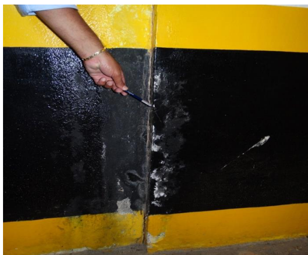
Figura 36 - Mancha por infiltração.
