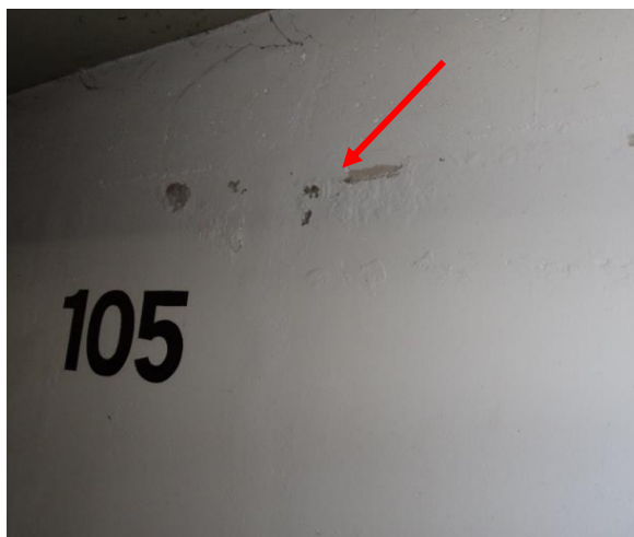
Figura 37 - Mancha por infiltração
