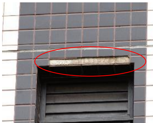
Figura 24 - Deslocamento do revestimento cerâmico Fachada Oeste.
