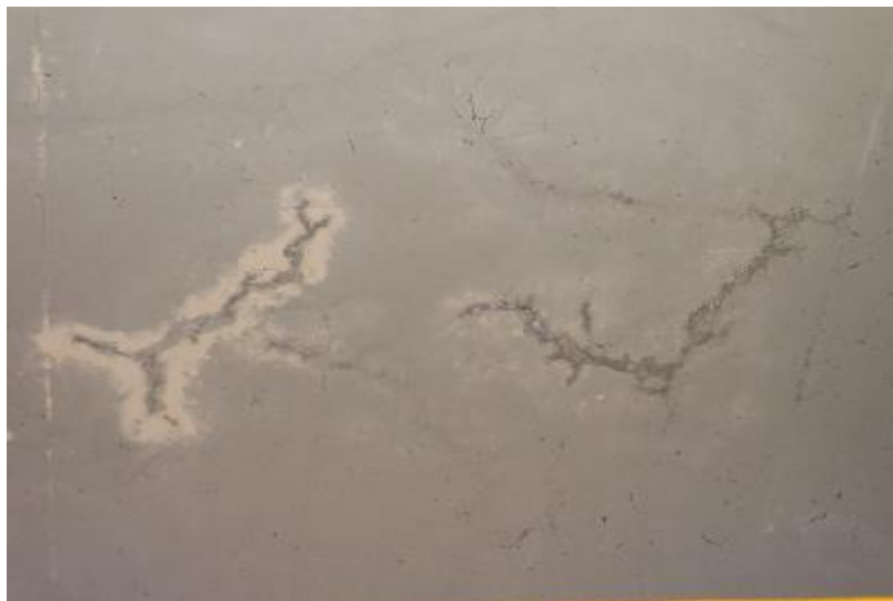
Figura 35 – Fissuras e Manchas no teto do Subsolo.
