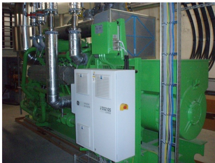
Obr. 30 Kogenerační jednotka GE Jenbacher JGS 312 GS-B.LC 637 kW
