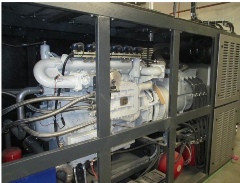
Obr. 47 Odkrytovaná kogenerační jednotka Viessmann Vitobloc 200 EM-199/263
