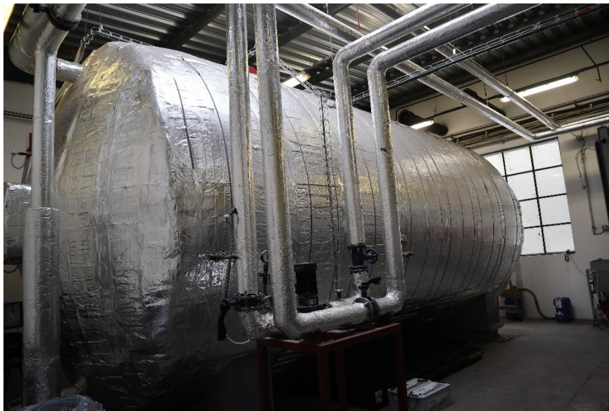
Obr. 49 Akumulační nádrž 60 m 3
