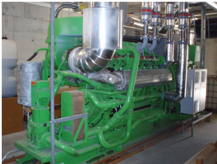
Obr. 38 Kogenerační jednotka Jenbacher JGS 312 GS-B.LC
