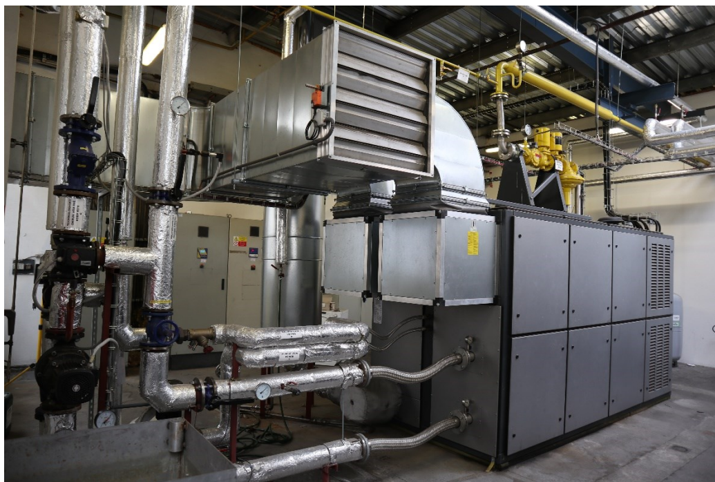
Obr. 5 Kogenerační jednotka Viessmann Vitobloc 200 EM-199/263 z boční strany
