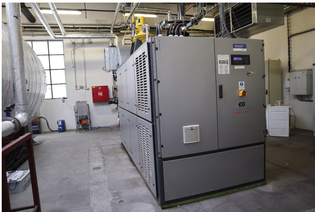
Obr. 4 Kogenerační jednotka Viessmann Vitobloc 200 EM-199/263 z čelní strany
