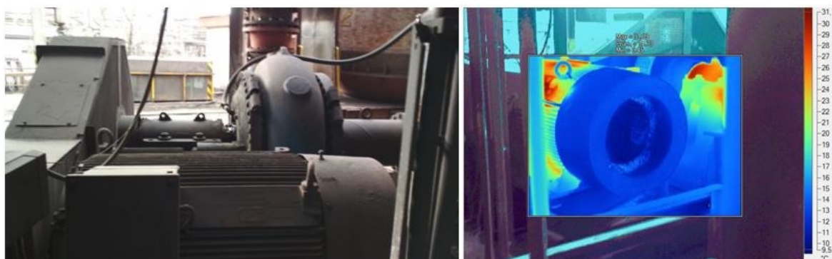
Obrázek 5.14 – Termosnímek motoru čerpadla Warman 14-12 GG u VP4
