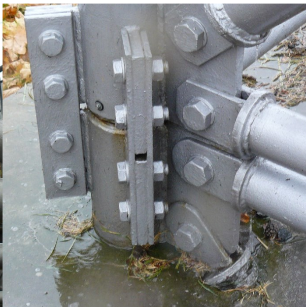
Obr. 2.4 - 2 – Koroze na montážním styku 2
