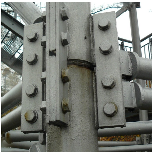
Obr. 2.4 - 1 – Koroze na montážním styku 1
