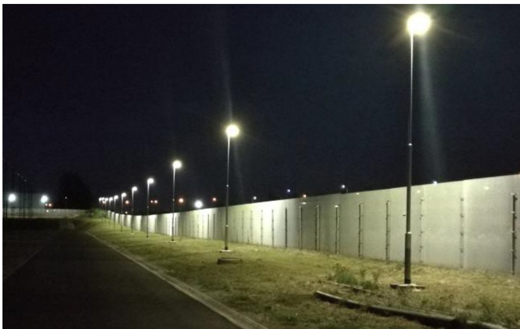
Obrázek 1-hlídací osvětlení v transformovně N
