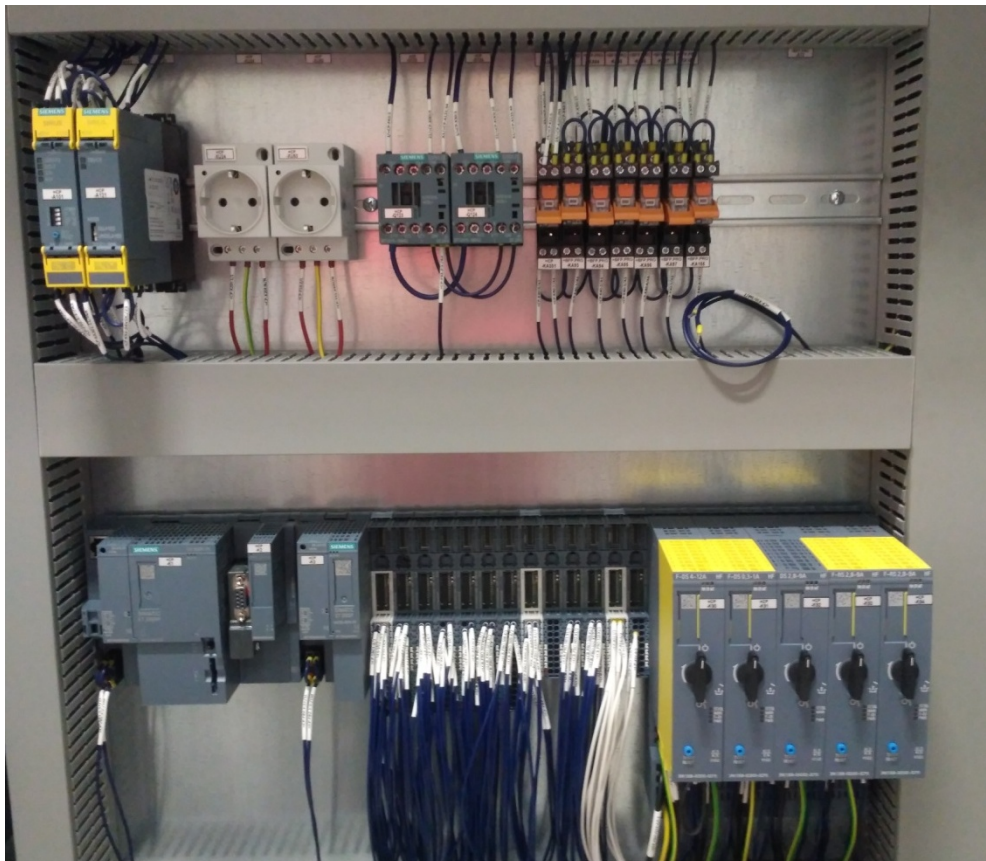
Obr. 6 Část zapojení rozvaděče
