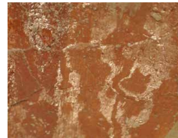
225. Particolare durante la pulitura: presenza di colature di resina epossidica sulla superficie policroma, probabilmente residui di un intervento sulla travatura sovrastante.
