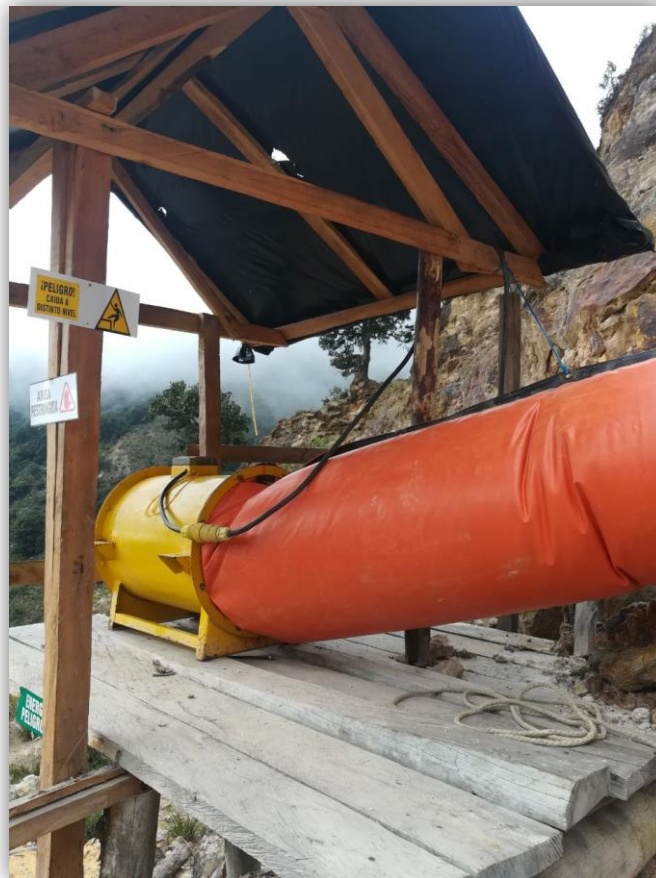
Fotografía 2. Ducto de ventilación Mina Malvinas
