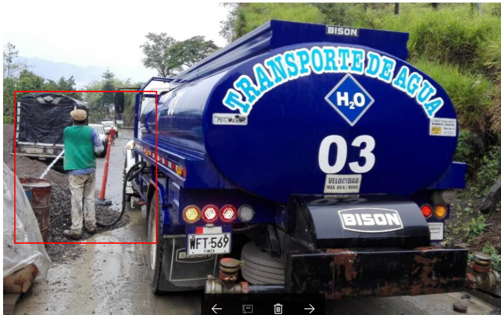
Figura 5. Lavado del agregado grueso para la construcción de los caissons del K11+100
