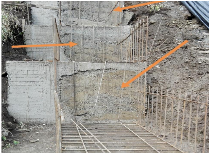
Figura 27. Daños causados en el canal debido al mal vibrado del concreto
