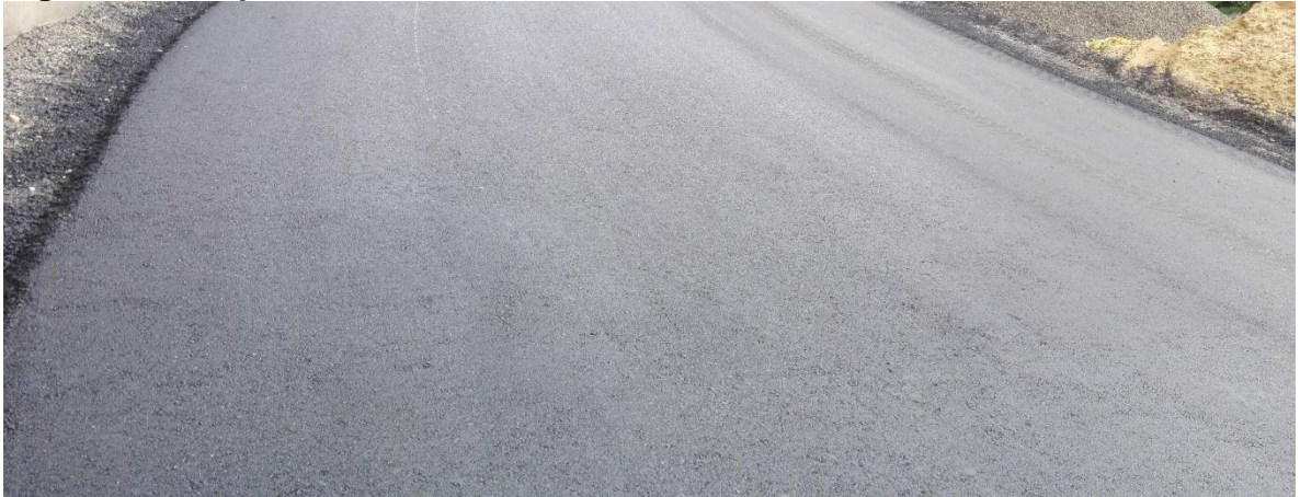
Figura 23. Carpeta asfáltica K15+140
