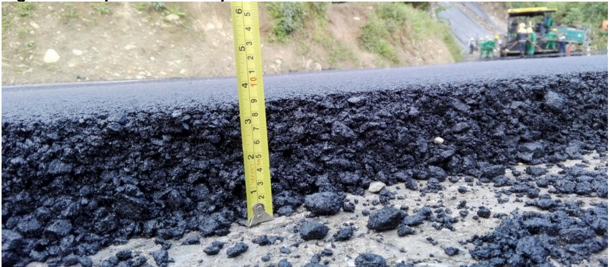
Figura 24. Espesor de la carpeta asfáltica del K16+460
