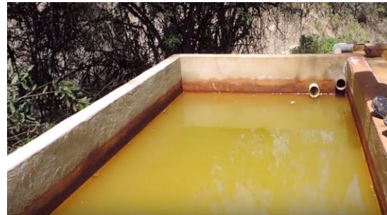
Figura 2.2c Tanque almacenamiento de aguas tratadas.
