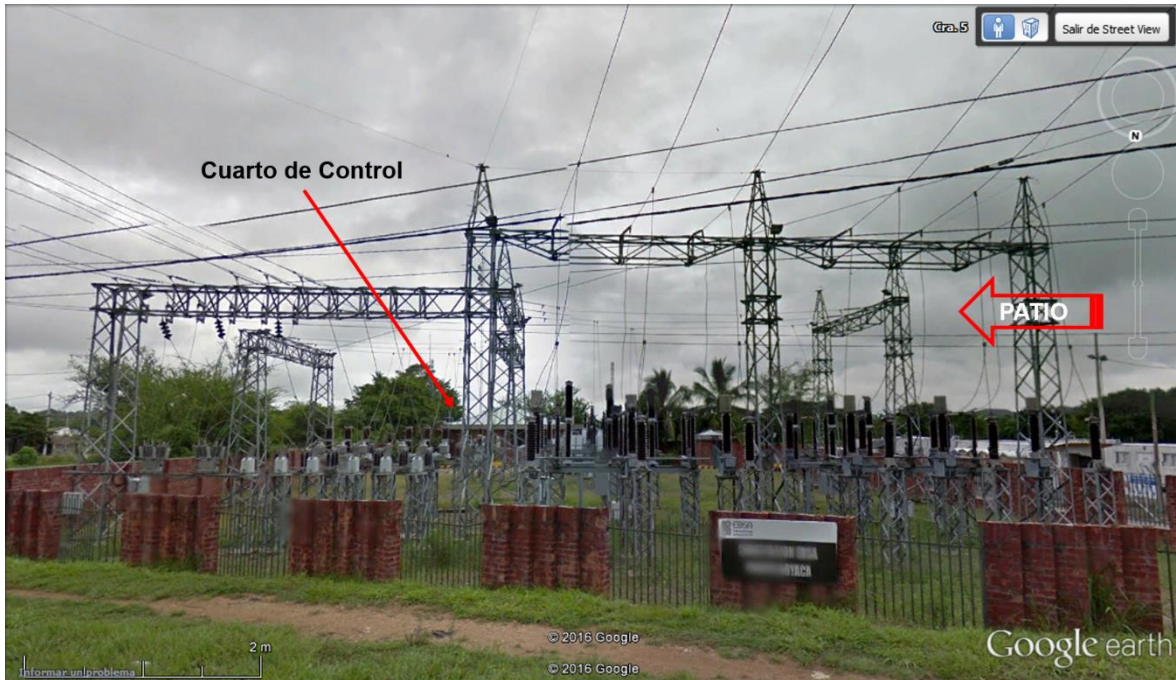
Figura 11. Vista con Street View de la Subestación Puerto Boyacá.
