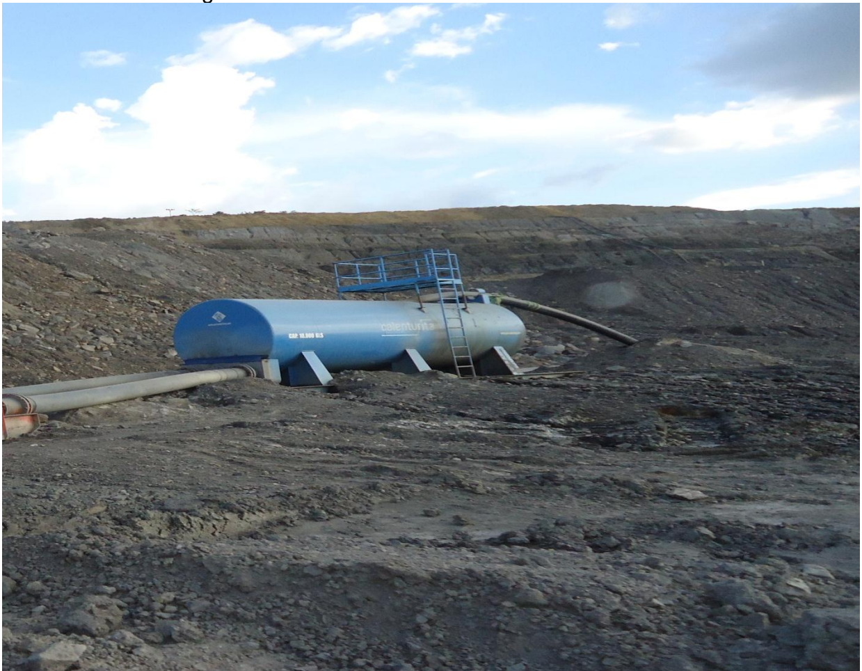
Figura 36. Sistemas de rebombeo o boosters.
