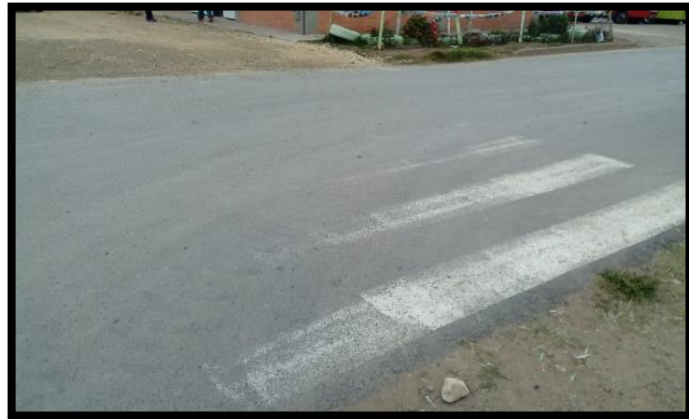
Figura 24. Señal Horizontal (Cebra) en mal estado
