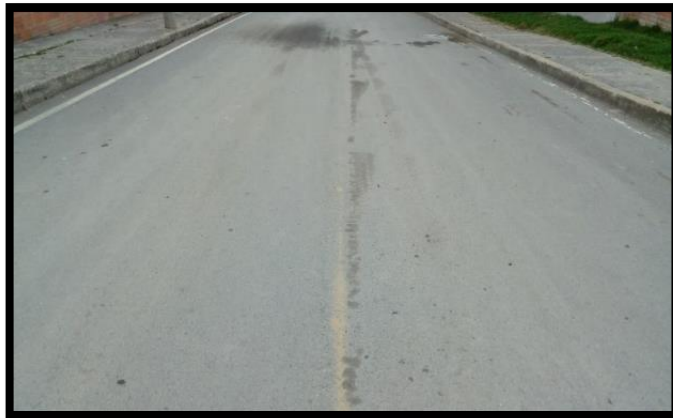
Figura 22. Señal Horizontal (Línea Central y Líneas de Borde de Vía) en mal estado
