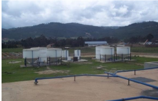
Imagen 9. Espesadores, Digestores y acondicionadores de lodos.
