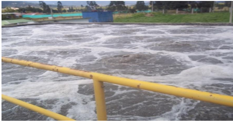
Imagen 2. Tanque de aireación.
