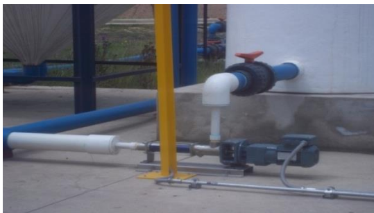
Imagen 10. Válvula de entrada de lodos
