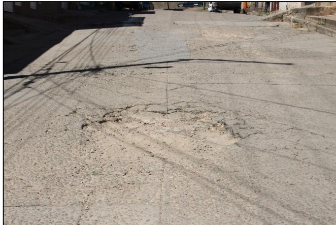
Daño en pavimento rígido
