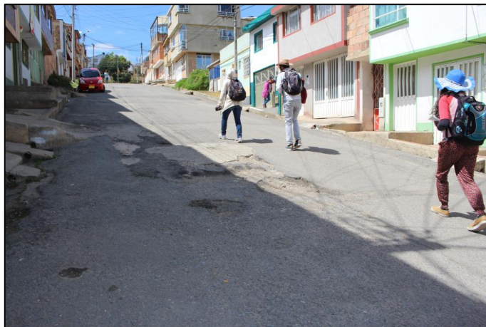
Daño en pavimento flexible
