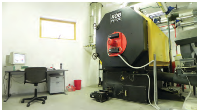
Caldia termica a biomassa dalla potenza di 600 KW installata presso l'azienda Legnolandia (UD)
