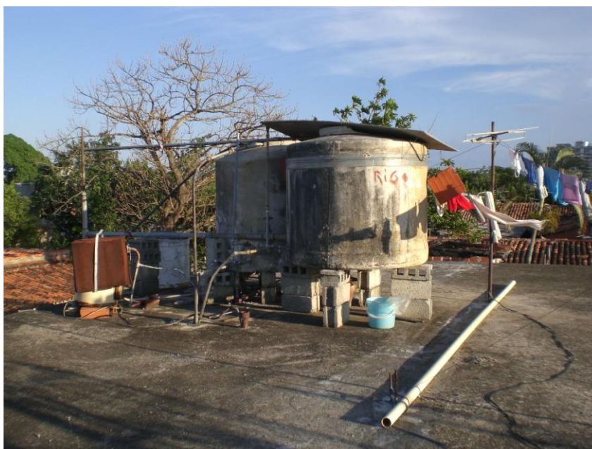
Figura 39 – Cisterne per l'acqua sui tetti delle case di Pinar del Rio
