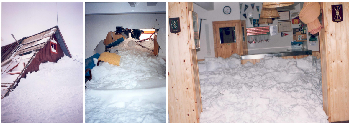
Figura 45.10: Estado de la fachada norte del refugio de Respomuso como consecuencia del alud (izquierda) y estado del interior del refugio de Respomuso como consecuencia del alud (centro y derecha). Fotografías: PRAMES.
