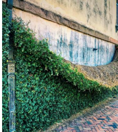
V19: Inventory (Damage)
