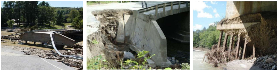
Approach scour (Lundlow, VT).
