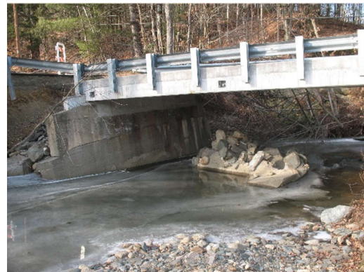
(d) Complete Scour Damage
