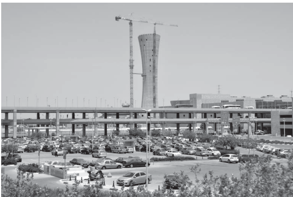
Il. 92. Budowa stumetrowej wieży kontroli lotów na lotnisku Ben Gurion (Pelleg Architects, 2014), 2014, fot. autor.
