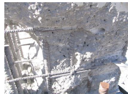
Porosidad provocada por exceso de agua de amasado
