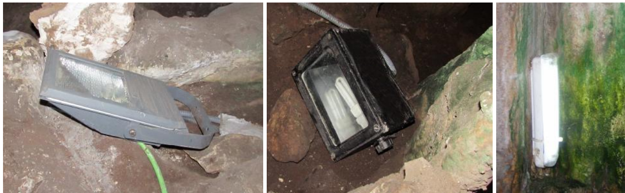
Figura 4.1. Diferentes lámparas de iluminación empleadas en la cueva de Nerja. De izquierda a derecha, halogenuro metálico (70 w), fluorescente para iluminación escénica (20 w) y fluorescente para iluminación vial (7 w).
