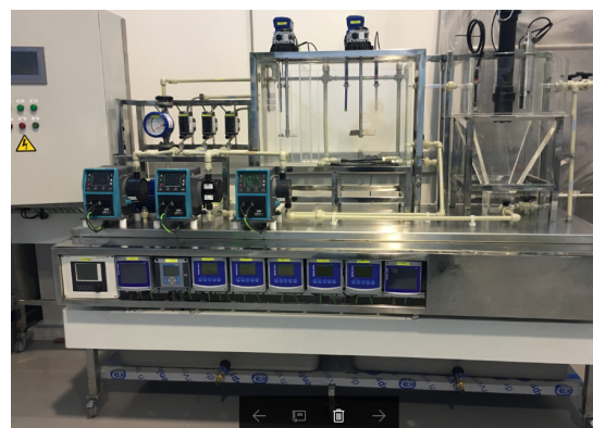
Figura 1: Planta experimental de tratamiento de aguas residuales.
