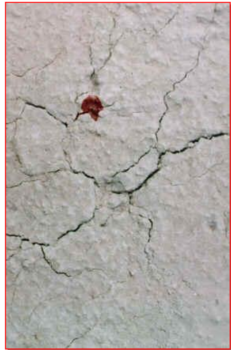
Fig. 4-1 Fisuras de retracción
