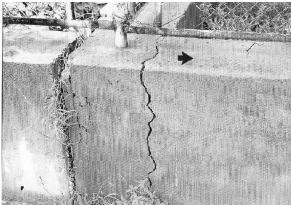
Figura 4-2: Fisura de retracción en una valla de hormigón en masa, consecuencia de la coacción existente en su extremo
