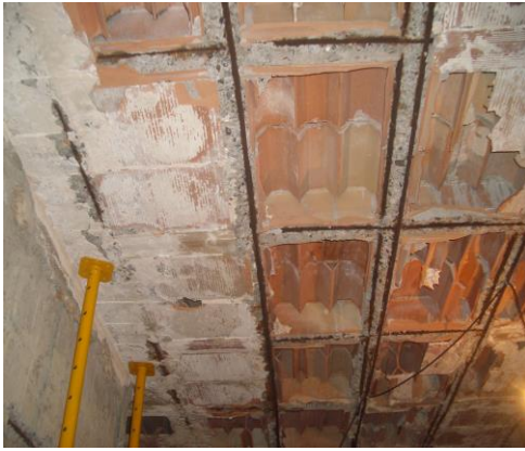
Figura 2-3: Corrosión de armadura en nervios de forjado reticular
