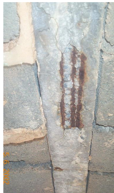
Figura 2-2: Corrosión de armadura en viguetas de forjado unidireccional
