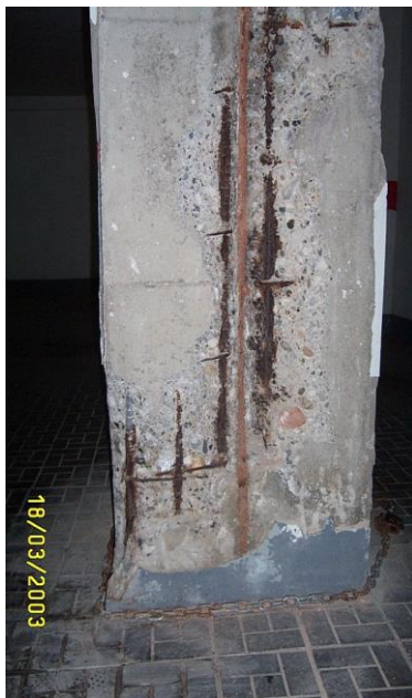
Figura 2-1: Corrosión de armadura en pilares
