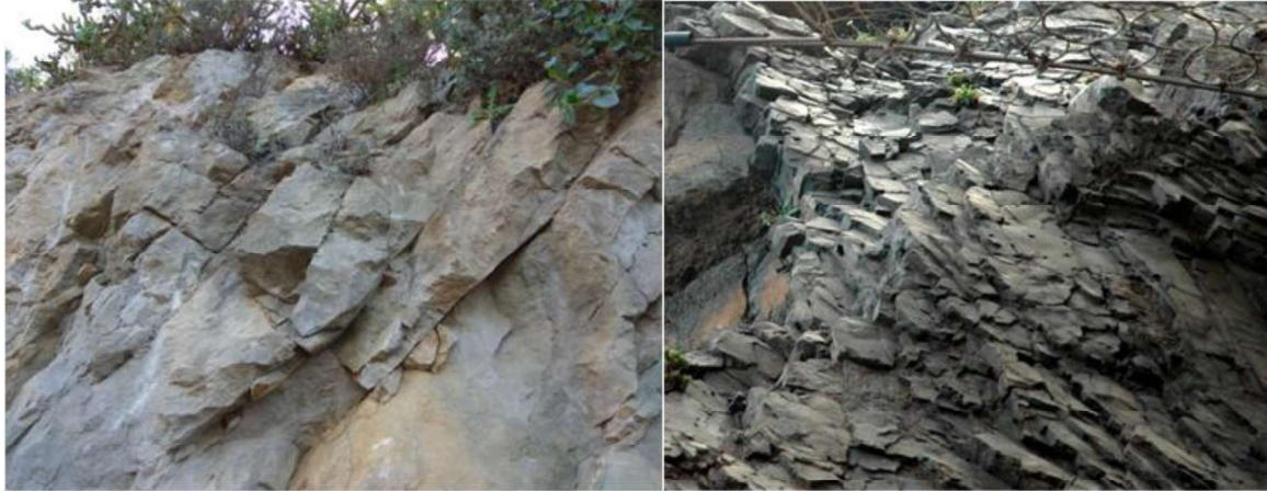
Figura 4.6. Ejemplos de grados de fracturación. A la derecha macizo moderadamente fracturado, a la izquierda muy fracturado. (Fotos: Ana Miranda).
