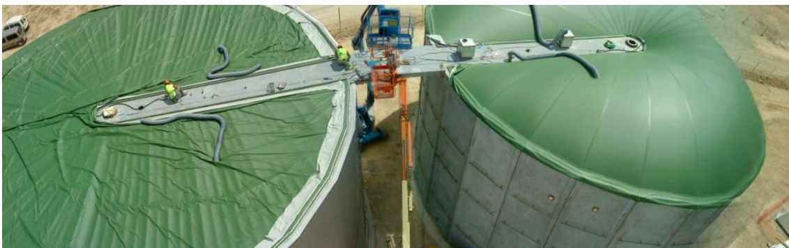
Figura 16. Cubiertas de doble membrana en tanques de almacenamiento de biogás. Fuente: Upbiogas
