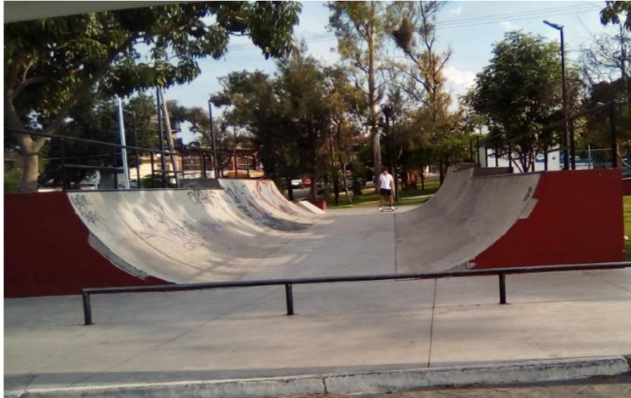
Foto 4. Skatepark : Loma Bonita. Sección: Mini ramp .
