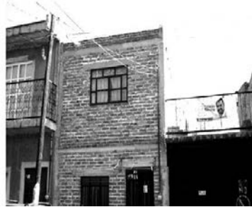
d) Mal confinada.
