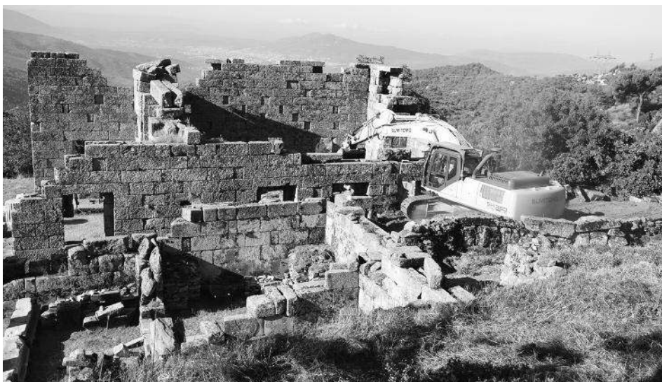
Fig. 68 : Les travaux de dégagement du naos de l' Andron A (O. Henry).
