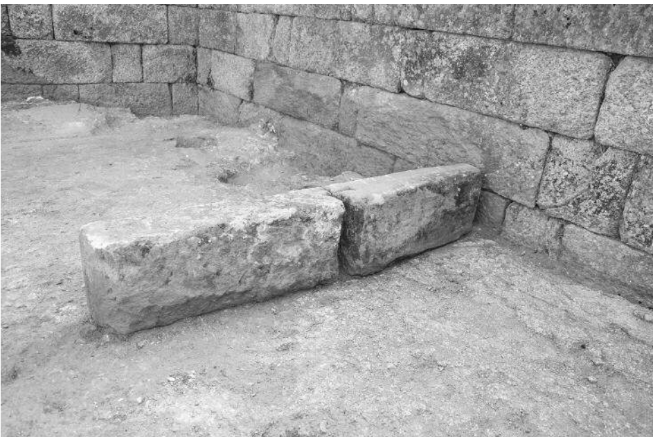
Fig. 73 : Vue des blocs AA06 et AA07 dans leur état réutilisé (O. Henry).
