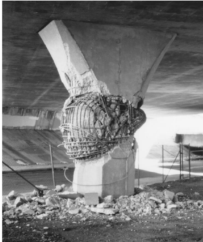
Figure 2.6 : Rupture d'une pile suite à la descente de la rotule plastique lors du séisme de Northridge de 1994 (tirée de J. Moehle, P. et Eberhard (2003))
