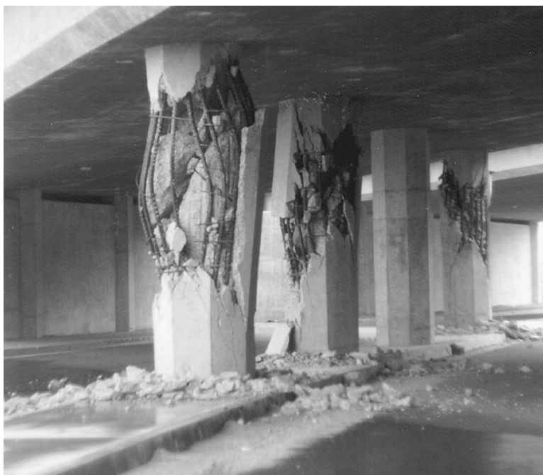
Figure 2.1 : Rupture en cisaillement de piles avec peu d'armature de cisaillement suite au séisme de San Fernando en 1971 (tirée de J. Moehle, P. et Eberhard (2003))
