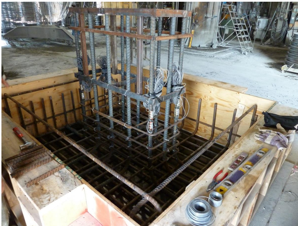
Photo 5 : Mise en place des barres jaugées dans la cage de la semelle S5 (7 août)
