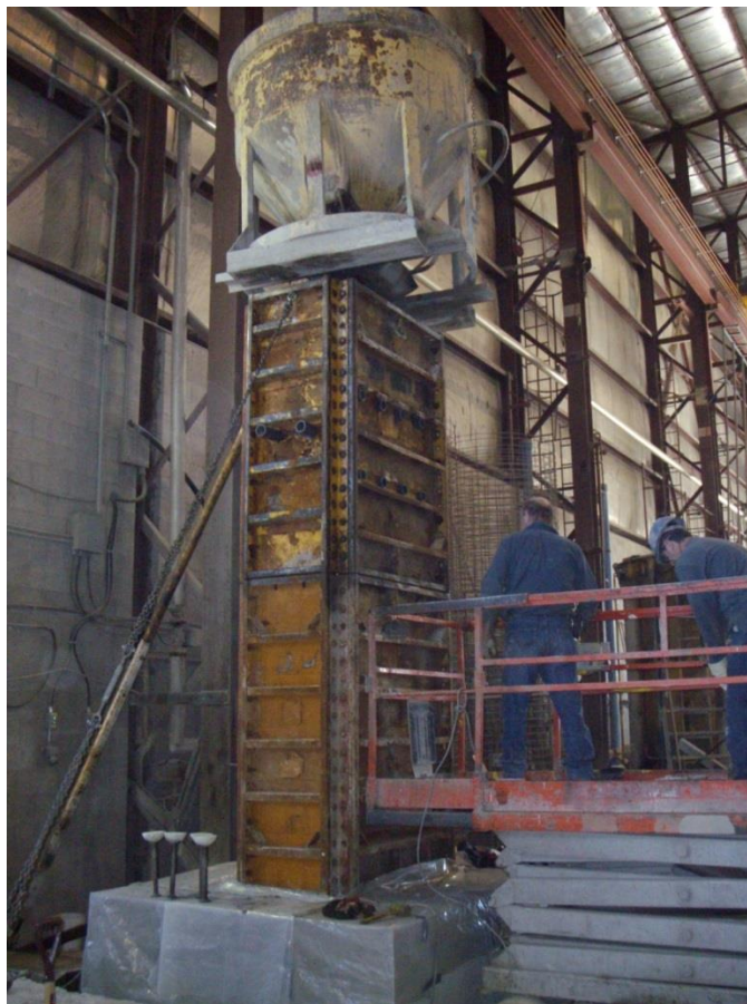
Figure 4.8 : Chute du béton lors de la fabrication des piles
