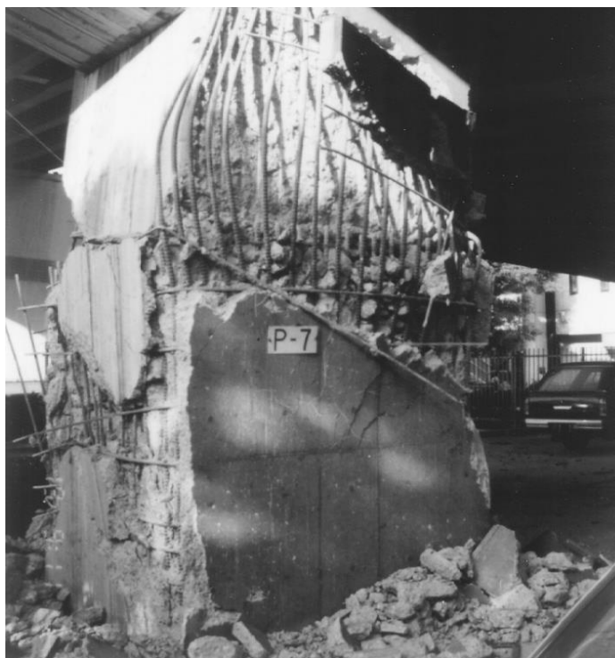
Figure 2.3 : Rupture d'une pile possédant un joint de chevauchement lors du séisme de Hyogo-Ken Nambu de 1995 (tirée de J. Moehle, P. et Eberhard (2003)).
