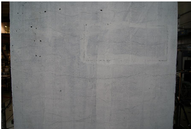
Figure 3.23 : Fissures de retrait sur la face ouest de la pile S6
