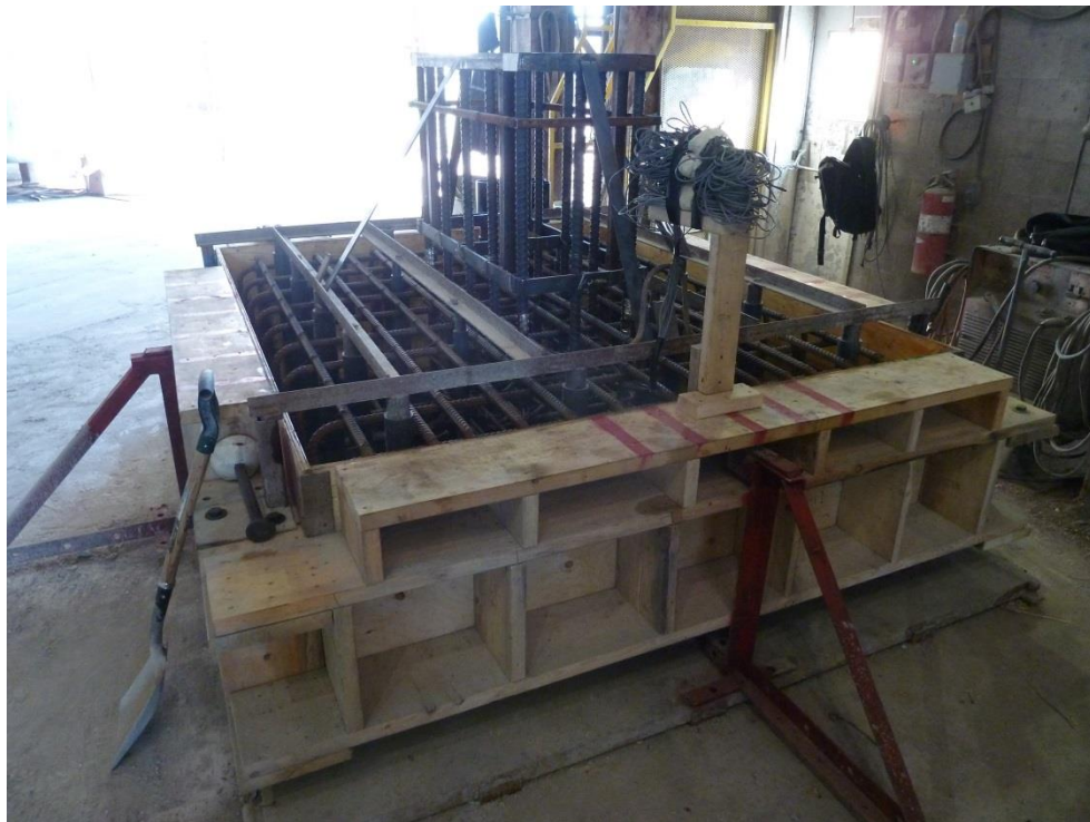
Photo 7 : Mise en place du support pour assurer la verticalité des tubes de PVC (8 août)
