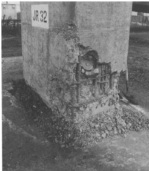
Figure 2.2 : Rupture par perte d'ancrage des barres chevauchées dans la zone de rotule plastique suite au séisme de Loma Prieta en 1989 (tirée de M. J. N. Priestley et al. (1996))
