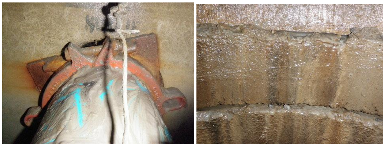
Figure 7.2 Photos prises lors de la visite de chambres d'aqueduc: joint entre la conduite et le mur de la chambre (à gauche) et joints entre les anneaux de béton préfabriqué du puits d'accès à une chambre (à droite)
