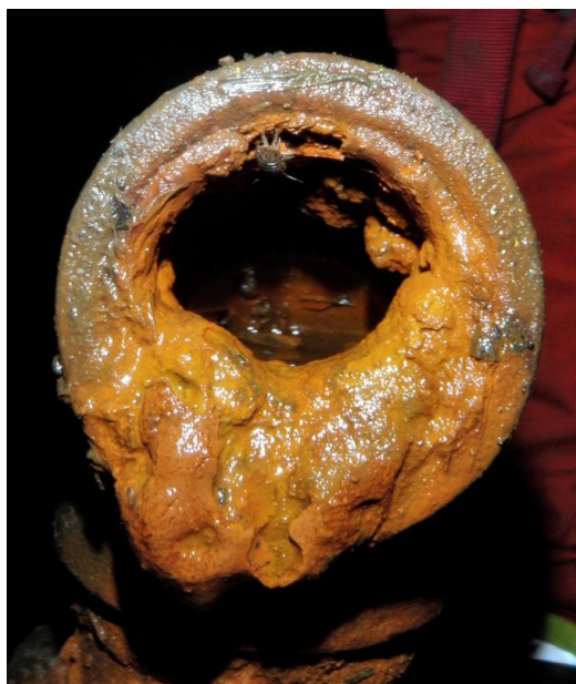
Figure 1.5 Orifice d'échappement d'une vanne à air après la vidange par pompage d'une chambre inondée dans le réseau étudié
