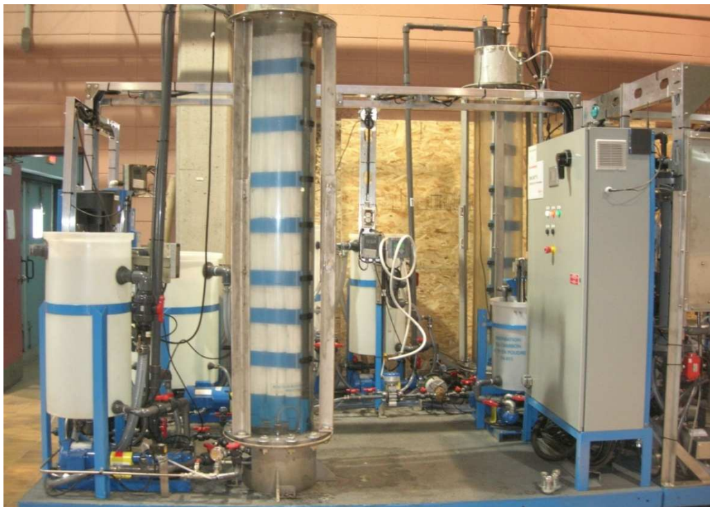
Figure 4-2. Les deux réacteurs du pilote Opaline-B situé à l'usine Sainte-Rose
