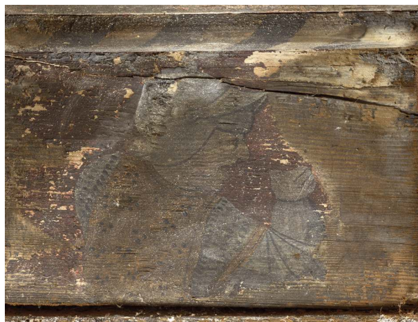
Fig. 2. Puisserguier (Hérault), maison du viguier ; vue générale du closoir C54. La couleur gris bleuté de l'armure du soldat est obtenue par un mélange de bleu indigo et de noir de charbon sur lequel sont superposées des lignes blanches et noires. O. Guillon © CICRP.
