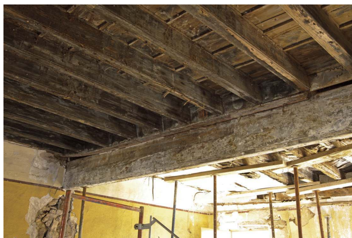
Fig. 1. Puisserguier (Hérault), maison du viguier ; vue générale du plafond. O. Guillon © CICRP.
