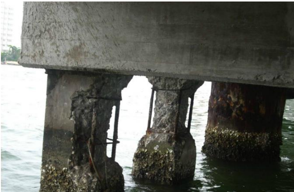
Figura 1. Corrosión del refuerzo (Echeverry, 2014)
