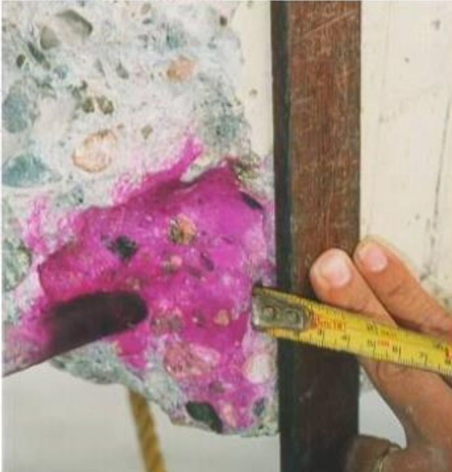
Figura 2. Corrosión por carbonatación
