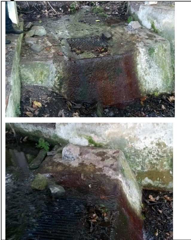
Figura 15. Bocatoma de Fondo Acueducto Tena
