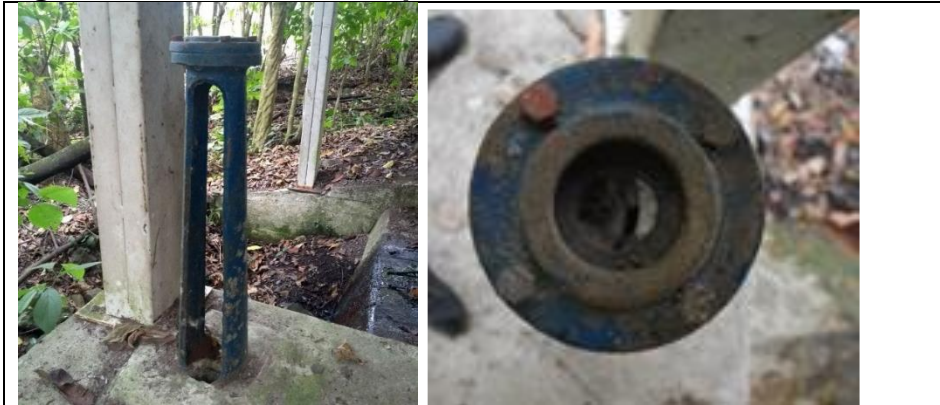
Figura 18. Válvula de Compuerta de la Cámara de Recolección
