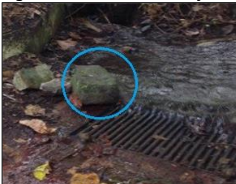
Figura 16. Estado de la Rejilla de la Bocatoma de Fondo
