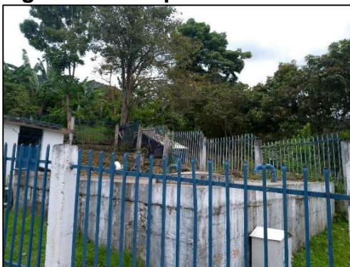
Figura 29. Tanques de Almacenamiento
