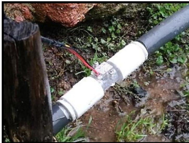
Figura 26 Sensor de Flujo instalado
