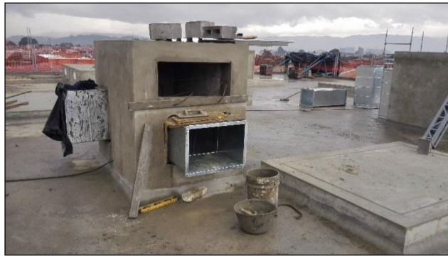
Figura 49. Ductos laboratorio central Registro fotográfico, Grupo LHS (2018)
