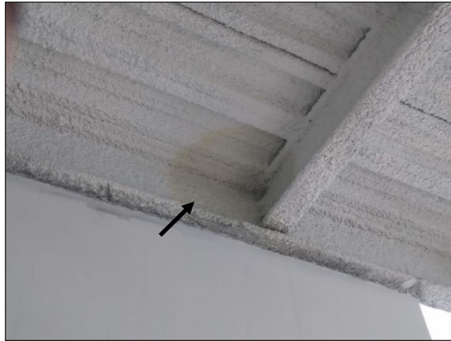
Figura 79. Problemas de humedad en el edificio central. Autores
