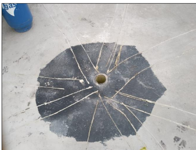
Figura 32. Fisuras Registro fotográfico, Grupo LHS (2018)
