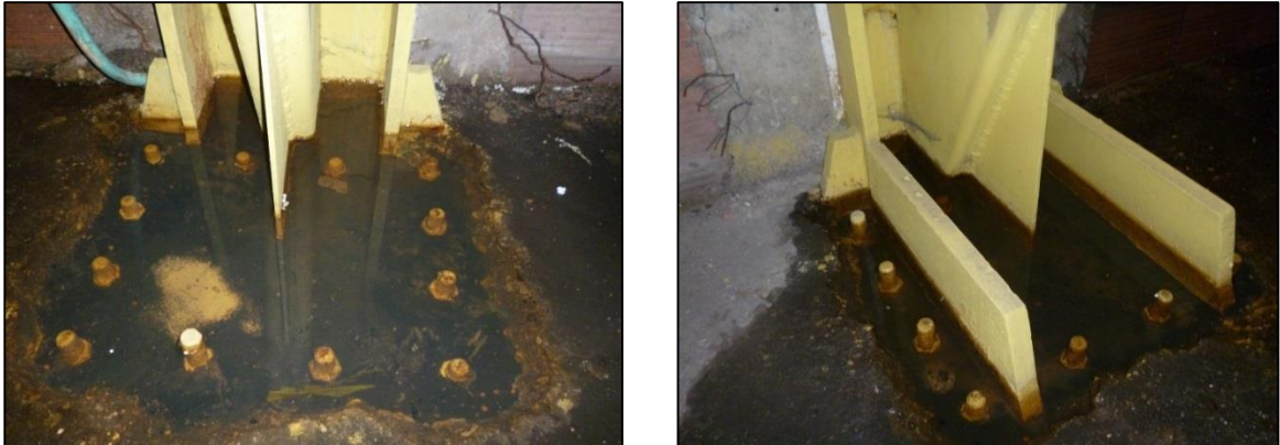
Figura 39. Detalle corrosión en base. Universidad de Antioquia, memoria estructural 2015.
