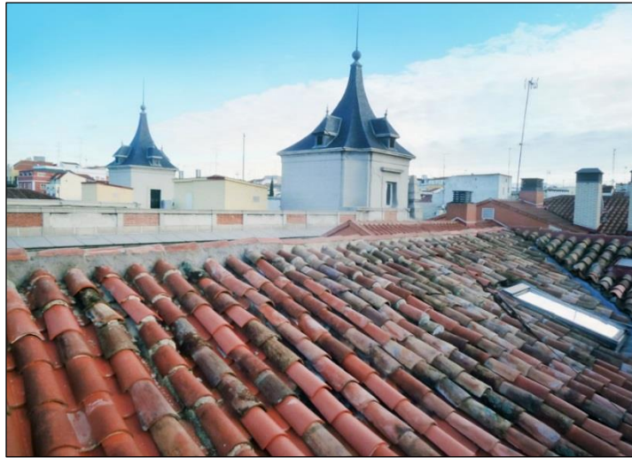
Figura 33. Desprendimiento cubierta de barro. SANTAMARTA, Pedro Gonzáles. Rehabilitación de cubiertas, patios y fachada de un edificio en Malasaña. [En línea] 10 de Febrero de 2015. http://santamartaarquitectos.blogspot.com/2015/02/rehabilitacion-cubiertas-patios-fachada-edificio.html
