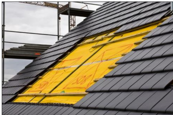
Figura 30. Aislamiento térmico. ECOGREEN HOME. Cómo evitar pérdidas energéticas en una buhardilla. [En línea] [Citado el: 3 de Octubre de 2018.] https://ecogreenhome.es/como-evitar-perdidas-energeticas-en-una-buhardilla-2/
