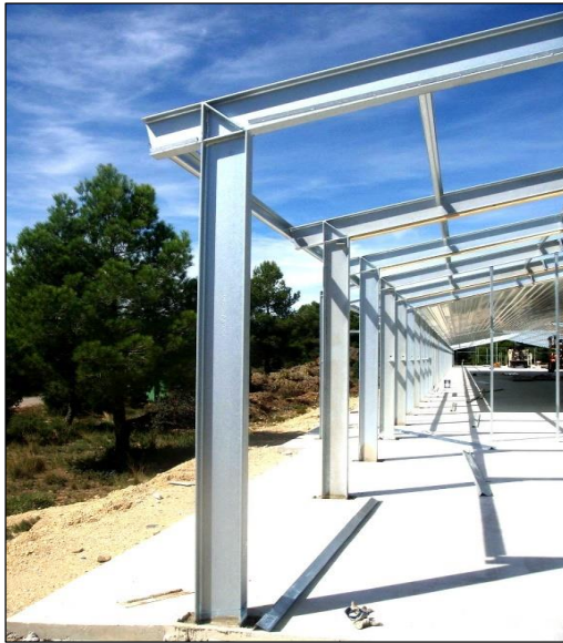
Figura 26. Pilares estructurales. PATEC. Naves construidas. Nave de gallinas camperas, en Sinarcas (Valencia). [En línea] https://www.patec.org/construidas/avicolas/camperas-Sinarcas.php#
