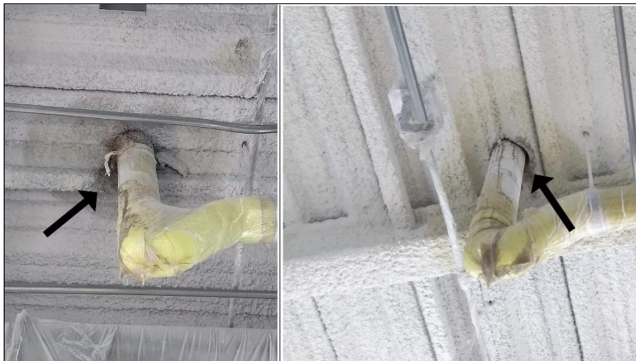
Figura 80. Problemas de filtración en el edificio central. Autores
