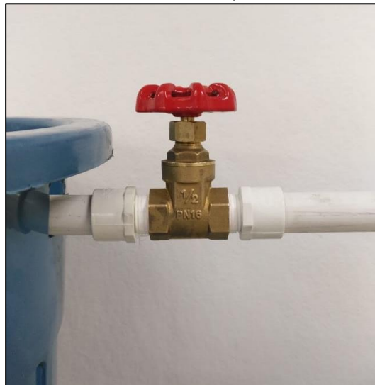
Figura 42. Calibración de caudal con Válvula de Compuerta
