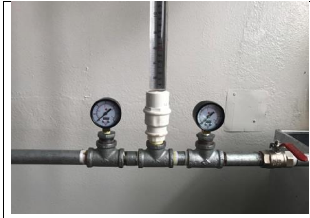
Figura 20 Chimenea de equilibrio o almenara y manómetros 1 y 2.
