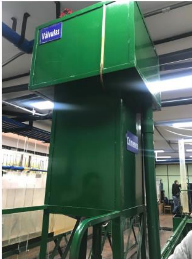
Figura 7 “Chimenea de equilibrio” Tanque de abastecimiento
