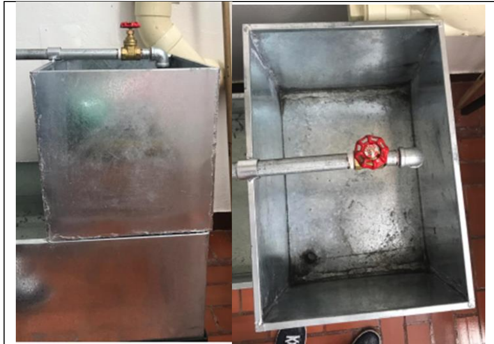
Figura 19 Tanque para aforo volumétrico y válvula de mariposa.
