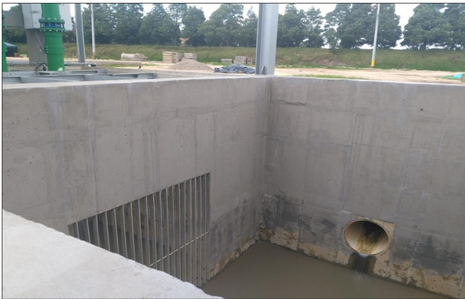
Ilustración 13. Hueco con reja de gruesos de 100 mm luz
