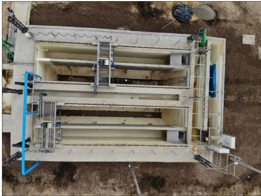
Ilustración 18. Desarenador-Desengrasado y Canaleta Parshall
