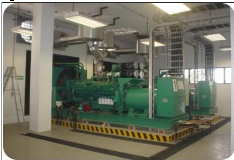
Figura 4. Planta eléctrica motor diésel Selmec
