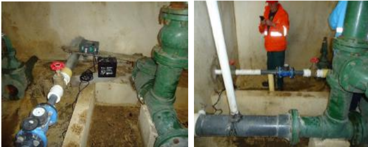
Ilustración 13 - Toma de caudales a la salida del tanque de abastecimiento
