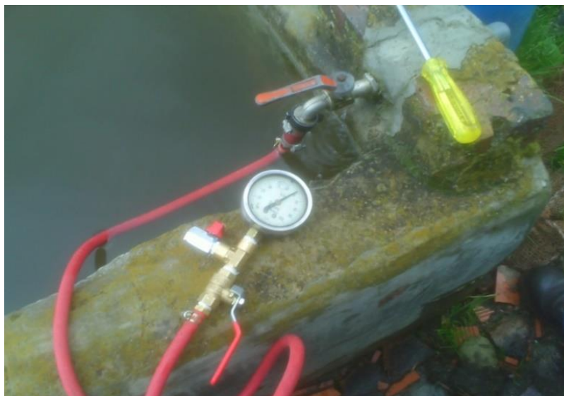
Ilustración 21 – Toma de presiones reales en las cámaras de presión
