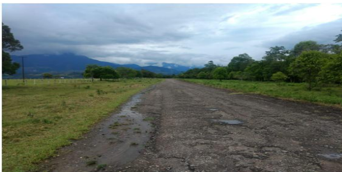
Figura 16 Pozos de Agua en el manto Asfaltico
