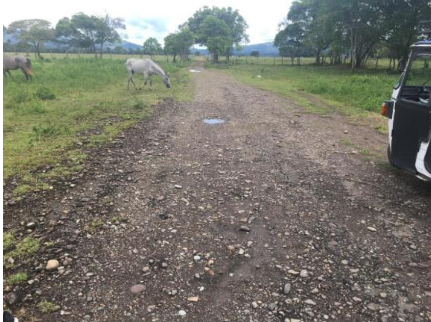
Figura 17 erosión y desprendimiento del pavimento
