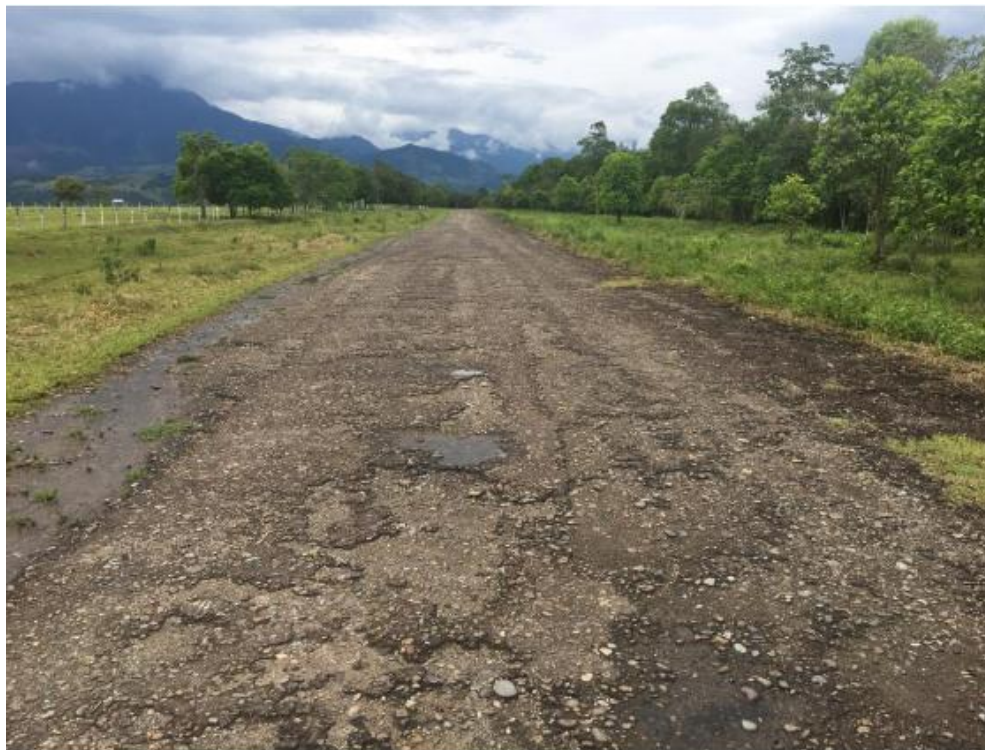
Figura: erosión del pavimento
