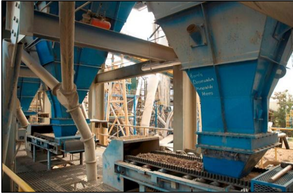
Figura 16. Banda dosificadora Minerales
