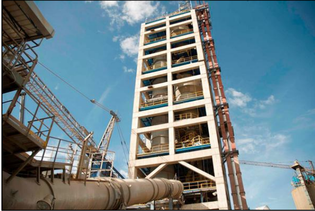
Figura 18. Torre de precalentamiento
