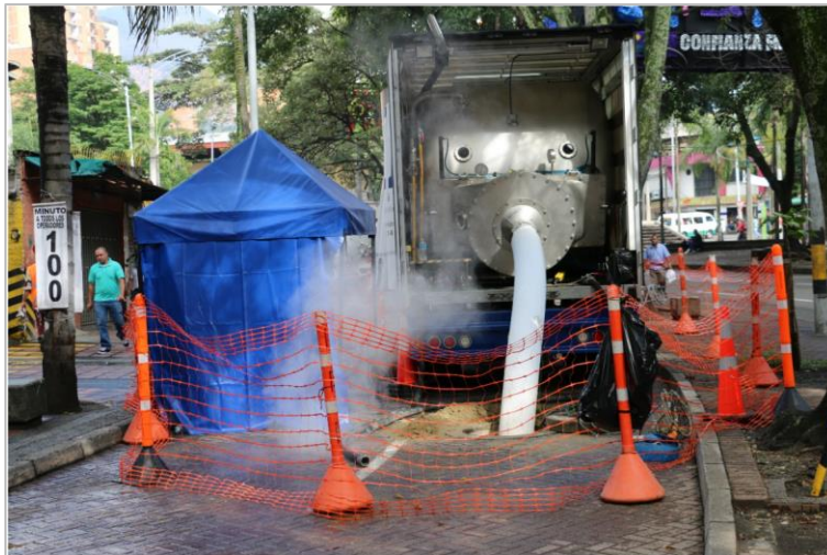
Fotografía 1. Proceso de inflado y curado - Tecnología CIPP para redes de alcantarillado Fuente: EPM con tecnología sin zanja interviene las redes del centro de Medellín [14]
