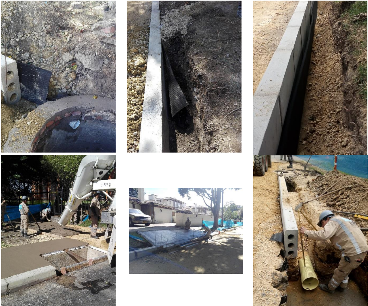
Ilustración 12 Fotografías instalación de Geodrén, adecuación de sumideros reglo de rampas de acceso.
