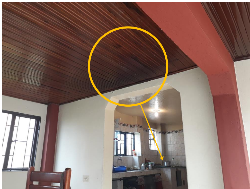
Figura 23. Identificación de patologías por estufa de carbón.
